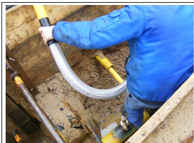
Bild 4: Einbau einer flexiblen Gasanschlussleitung im Querungsbereich des Rheindahlener Sprungs an der Talstraße
